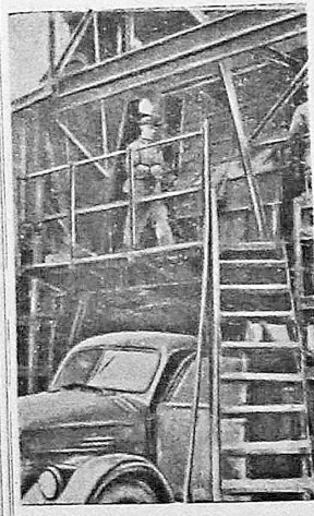
На асфальто-бетонном заводе наступила горячая пора. Ежедневно десятки автомашин отправляются отсюда с горячей массой, предназначенной для асфальтирования улиц. Уже выдано для укладки полотна дорог около 2.000 тонн асфальтобетона. На заводе внедрено предложение о механизации загрузки битума в котлы. Осуществление только этого мероприятия позволило высвободить для других работ 50 человек, занятых ранее на загрузке битума в котлы. На снимке: городской асфальто-бетонный завод. Фото Е. Абезгауза.
